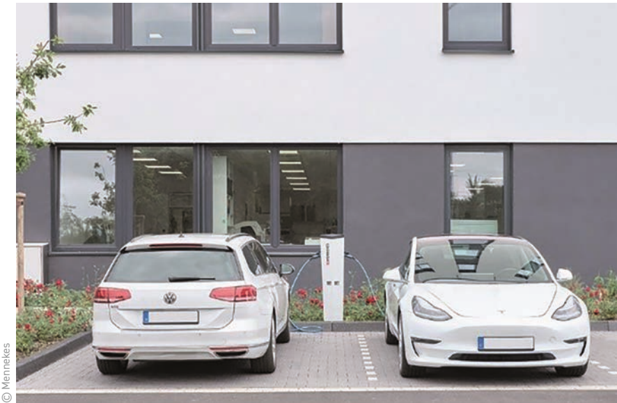
2 | Dargestellt ist eine Ladestation mit zwei Ladepunkten, beispielhaft an einer Arbeitsstelle.
